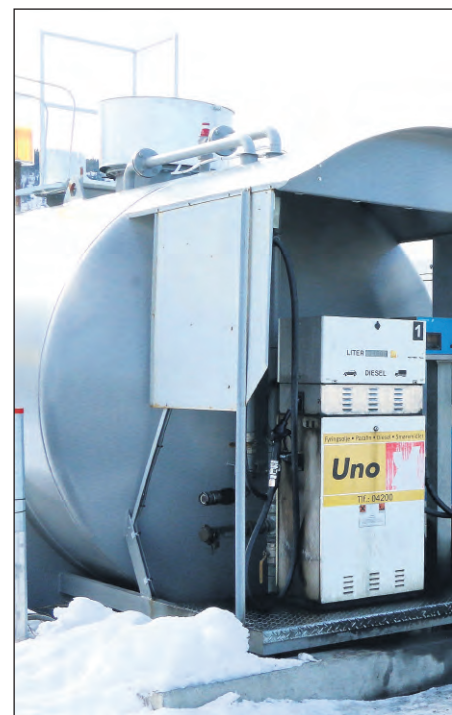
Dette er truckanlegget som nå skal oppgraderes.
